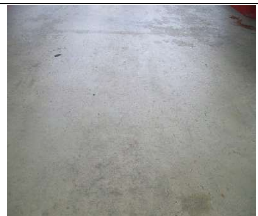
施工前の下地の様子 ガソリンや油がコンクリートに染み込み 表面がつるつるになっている
