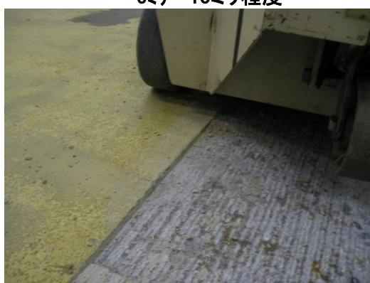
下地の状況 樹脂モルタル撤去と同時に下地コンクリートを削り、塗床に最適な地を作ります。
