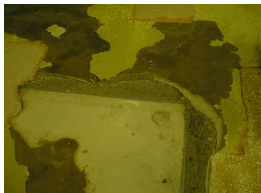
施工前の状況 MMA樹脂モルタルが塗り重ねられている 5ミリ~10ミリ程度
