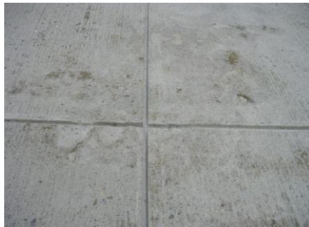
硬質ウレタン施工用土間カッター入れ カッター入れ専用機にて(幅10ミリ×深さ10ミリ)
